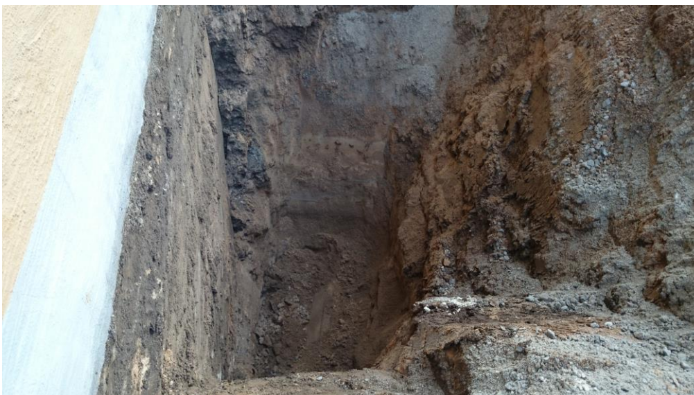
Bild 5; Provgrop PG1 vid byggnad inom Fåfängan 5. I botten av gropen syns utstickande sparsten.
