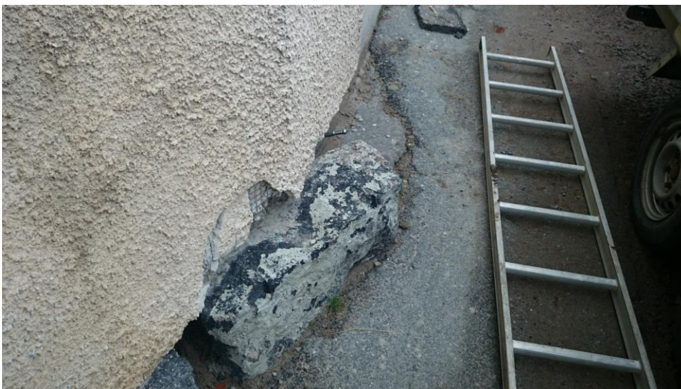
Bild 7; Sten i grundkonstruktionen för högdelen inom Fåfängan 10 som sannolikt blivit påkörd och även gett skador på den nedre delen av den reverterade fasaden. Bakom stenen finns en äldre avvägningssdubb.
