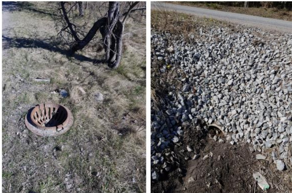
Figur 20. Bild A (t.v.), Kupolbrunn längs Gäddestavägen. Dimension 450mm. Bild B (t.h.) befintlig vägtrumma i betong under Gäddestavägen (dimension 300mm).
