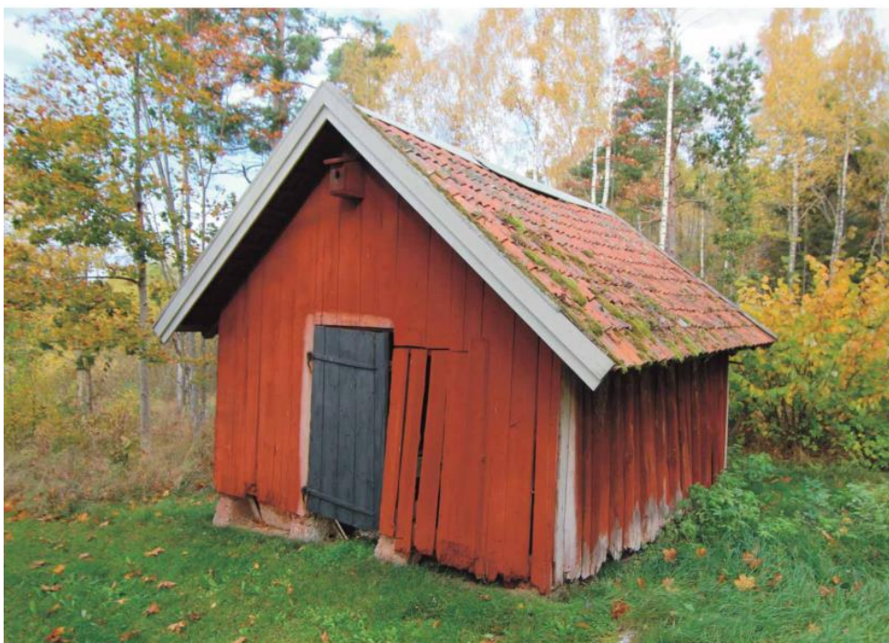
Förråd. Foto: Fredriksson arkitektkontor AB
